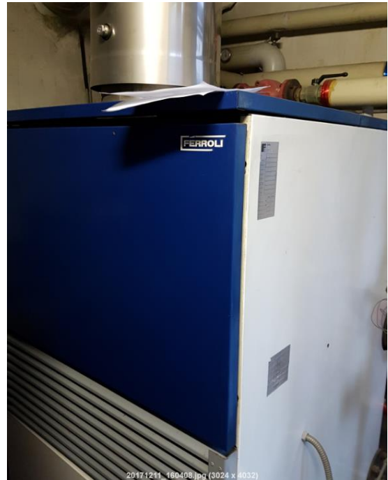
Figura 8.5 – Particolare della caldaia
