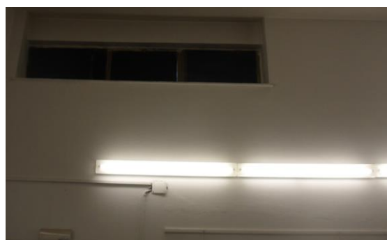
Figura 8.8 – Particolare di un corpo illuminante
